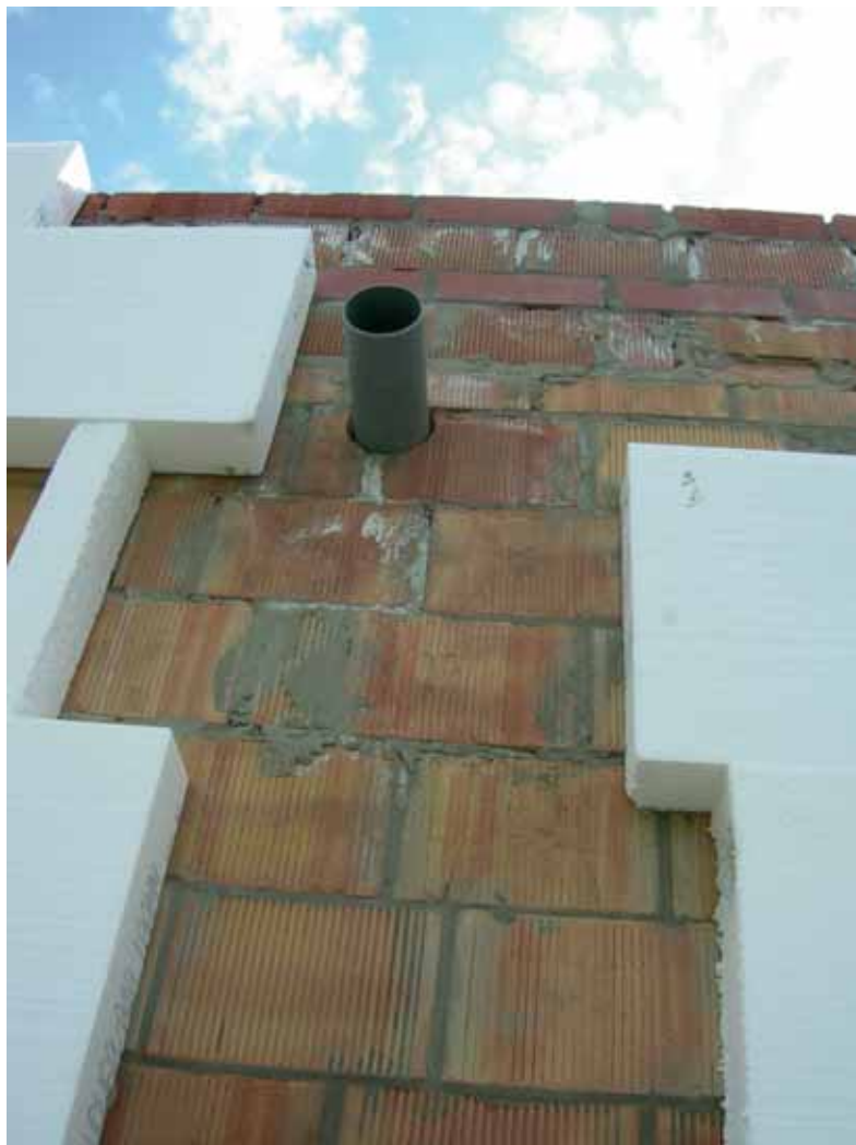
Afb. 9: Geen vochtwering ten gevolge van ontbrekende dakrand en hemelwaterafvoer.
