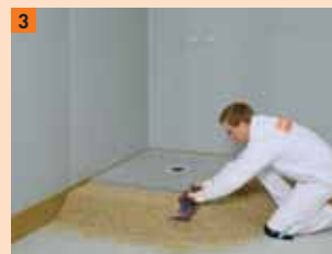
3 Variant 1a: rond het inlooptdouche-/vloerafvoerelement wordt ter hoogte van de uitstekende liplias een ca. 200 mm brede dam gestort, als steun voor het afreien van het verdere oppervlak van de ruimte
